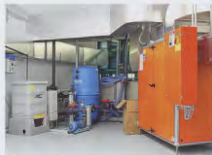
In dem großzügig dimensionierten Technikraum im Untergeschoss der Anlage ist die Schwimmbad- und Lüftungstechnik untergebracht.
